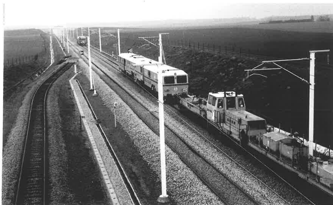
Travaux sur la L2 : en ce mois d'avril, le raccordement direct de la base de travaux à la LGV, et la bretelle associée, ont été démontés, les accès aux chantiers n'étant plus possibles que par Ans ou par Leuven. Divers engins s'affairent à restaurer le ballast à l'issue de ces travaux de démontage. Voroux, le 17/04/2002, photo G.B.
